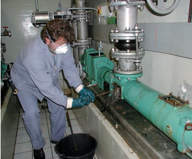
Reinigung einer Frischschlammpumpe
