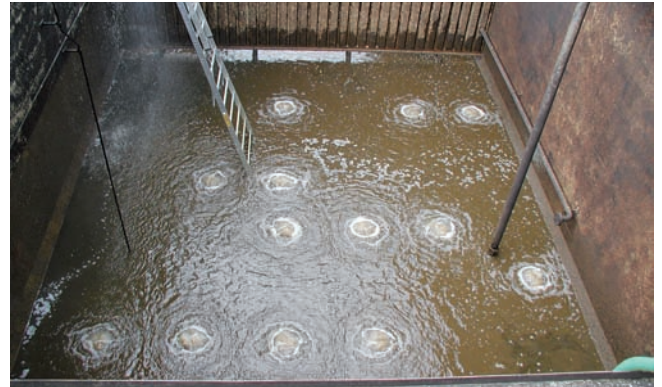
Beckenzone mit verstopften Belüftern
