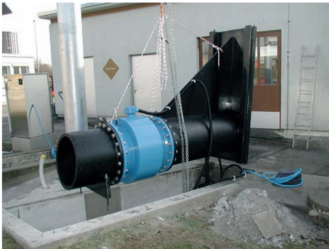
MID-Messung im Zuflusskanal
