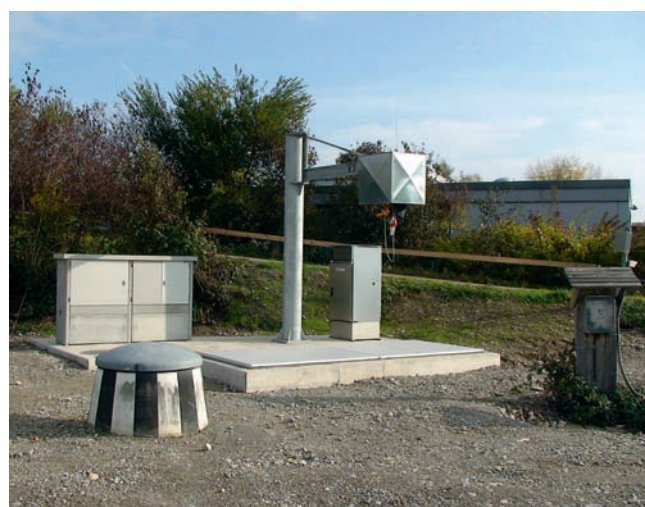
Mengenmessung im Kanal Kloten
