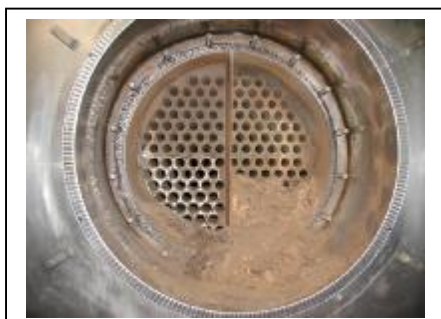
Abbildung 15: Ablagerungen im Wärmetauscher
