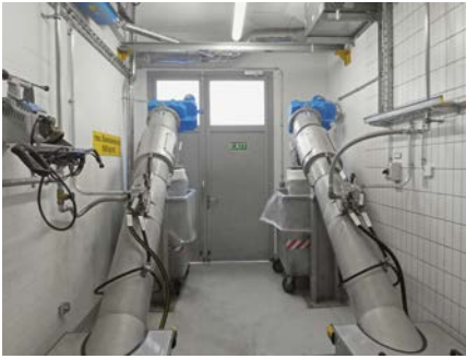
Siebanlage zur Entfernung der Feststoffe
