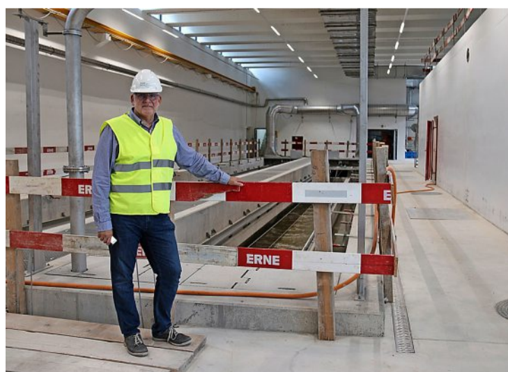
«Wir haben nun eine moderne, energieeffiziente, mechanische Vorreinigung», sagt Geschäftsleiter Michael Kasper. Fotos: bhk
