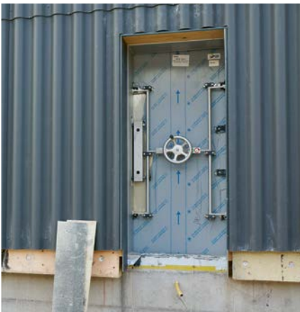
Drucktüren zu den Ozonreaktoren der EMV-Stufe (Entfernung der Mikroverunreinigung).
